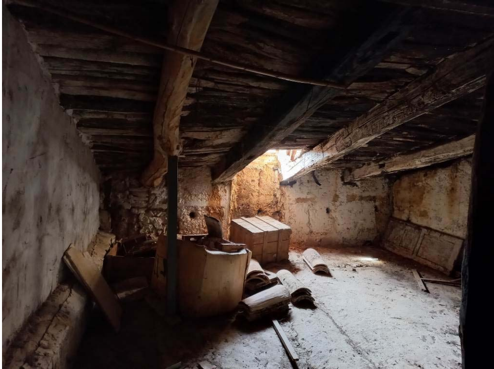
Foto 2. Estado actual finterior de faldón.
