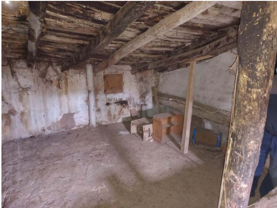
Foto 3. Estado actual con infiltraciones.
